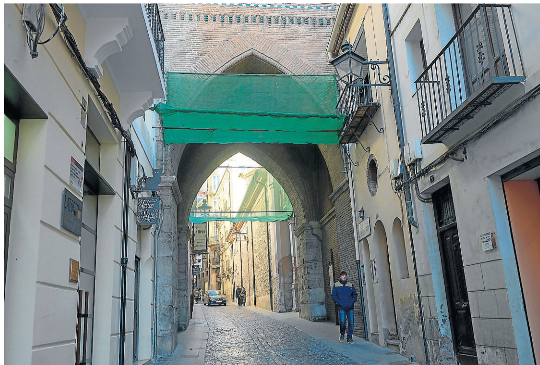
Dos mallas penden de la parte inferior de la torre para evitar desprendimientos sobre la vía. JORGE ESCUDERO
